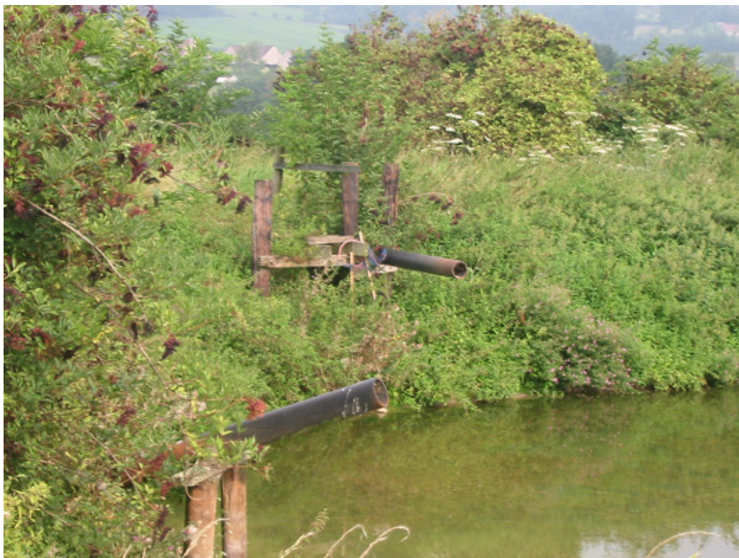
Photo 1 : Tuyaux arrivant dans le bassin n°7
