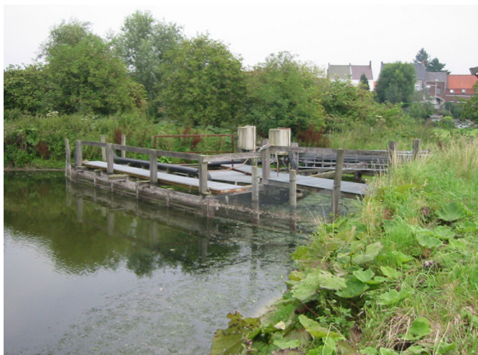
Photo 2 : Pompes du bassin n°12
